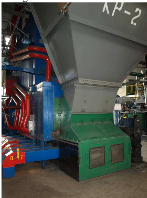
Rys. 5. Widok kotła parowego KP 2 typu OR-10
