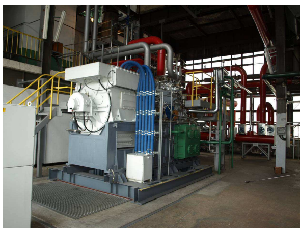
Rys. 6. Widok turbiny kondensacyjnej typu TG P 1,5 – 21/5 z generatorem prądu przemiennego
